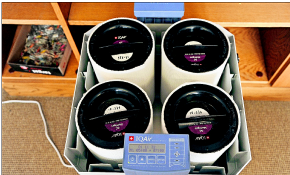
Die Aktivkohlefilter-Geräte bringen gute Werte in den Büros: Die Richtwerte für Formaldehyd werden alle unterschritten. KRZ-Foto: Thomas Bischof
